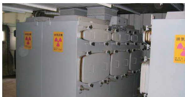
RI施設排気施設
