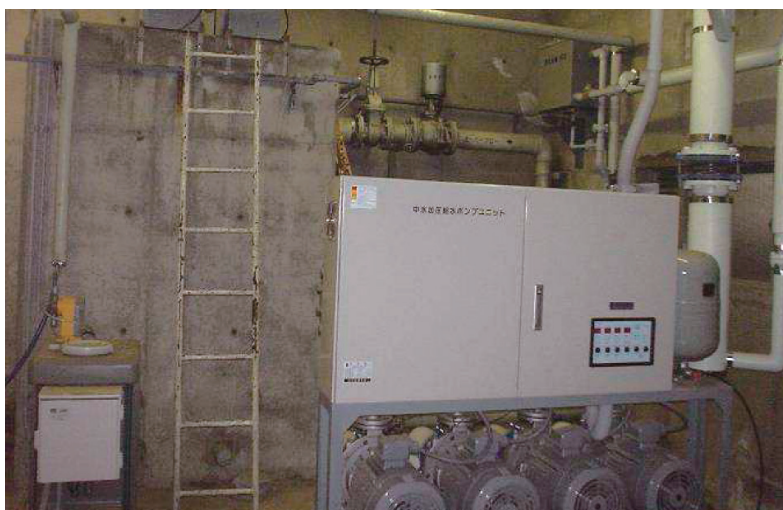
水再利用設備（中水設備）
