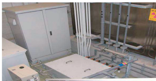
RI施設排水設備
