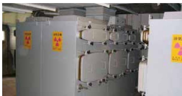
RI施設排気施設
