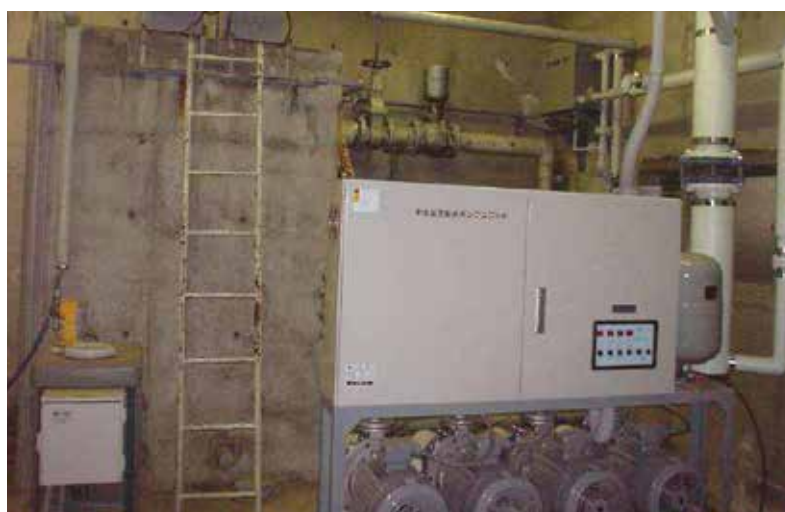
水再利用設備（中水設備）
