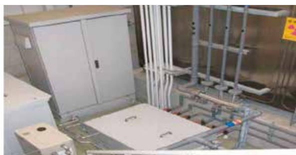
RI施設排水設備
