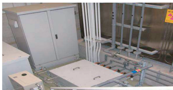
RI施設排水設備
