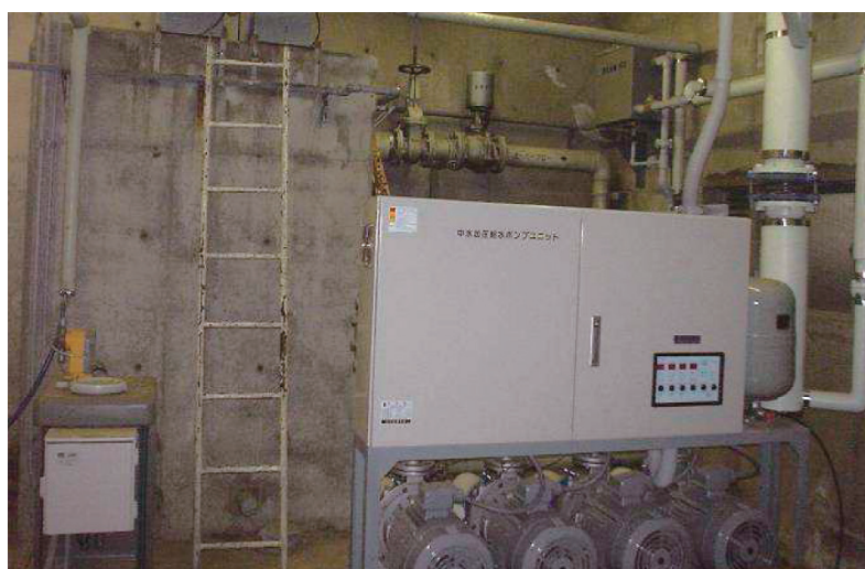
水再利用設備（中水設備）
