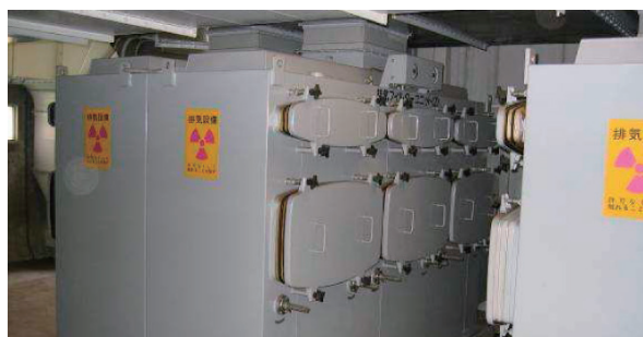
RI施設排気施設
